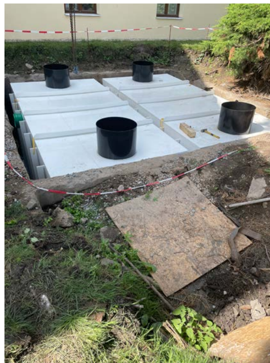
Nádrže na zachycování dešťové vody
